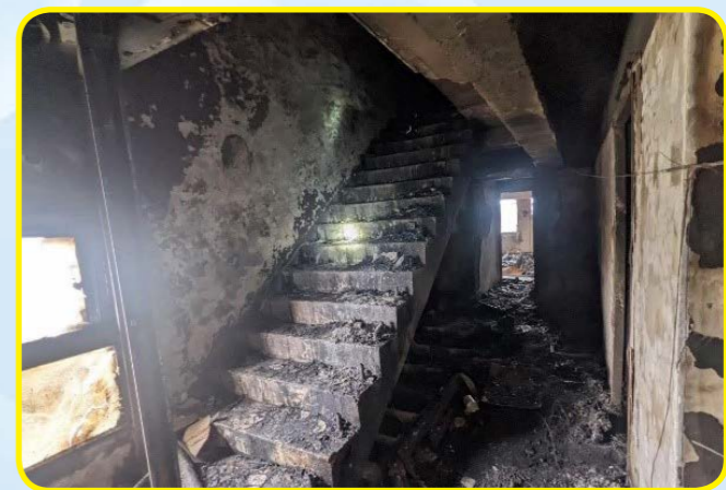
走廊及樓梯燒毀情形
