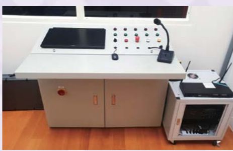
圖8 整合場內各項操控儀器及監視錄影控制台
