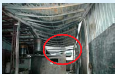
圖一：屋頂烤漆浪板受熱燻黑、變色；裸露之「C」型鋼橫於施工位置附近受燒、變色、彎曲最為嚴重；磚造水泥被覆牆面燻黑、變色、剝落；鋼架烤漆浪板外牆受燒、變色。
