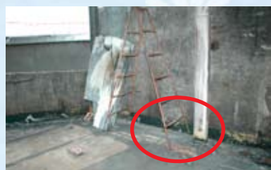
圖二：倚靠於牆面之烤漆浪板受燒、燻黑、變色；施工人員廖〇〇先生施工用之手持式砂輪機切割機外觀受燒、變色，遺留於現場。
