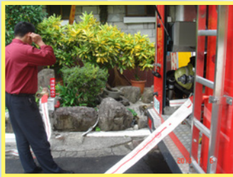
消防車連接送水口
