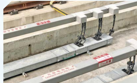
軌道區域重要供電設備迴路-第三軌
