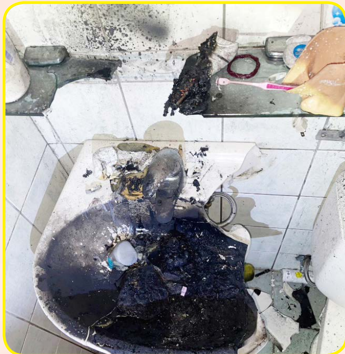
燒穿天花板抽風機機身砸破洗手台
