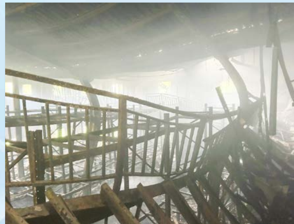
鐵皮工廠內部結構脆弱，經過火勢燃燒容易坍塌
